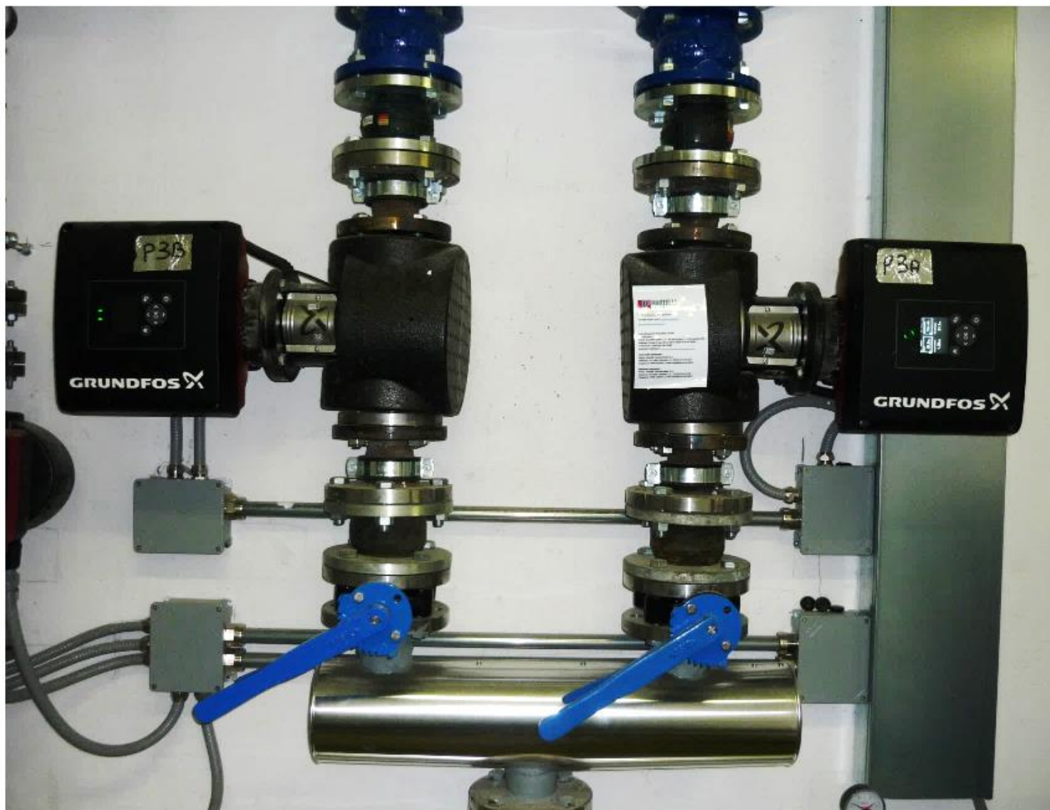
Circuiti idraulici e pompe di calore
